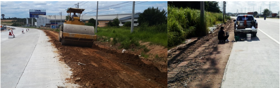
ภาพที่ 42 การบดอัดดินไหล่ทางให้แน่นป้องกันการกัดเซาะ
