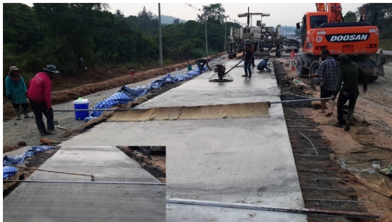
ภาพที่ 35 การแต่งผิวหน้าคอนกรีตที่เสียหายจากฝนตก
