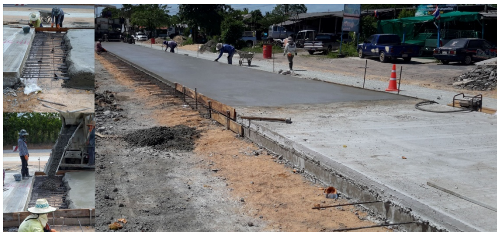
ภาพที่ 38 รอยต่อเพื่อการก่อสร้างจุดเริ่มต้นแต่ละวัน
