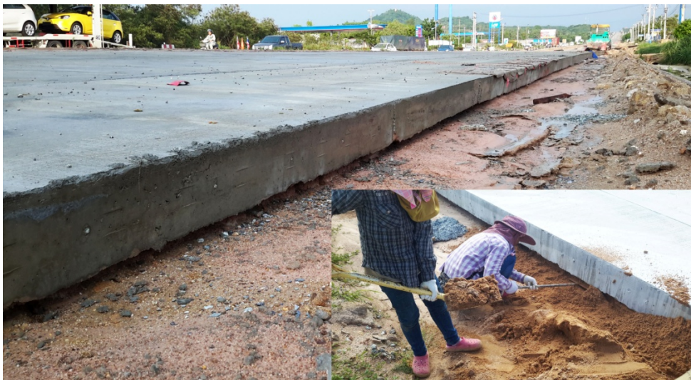
ภาพที่ 40 การกััดเซาะทรายรองถนนคอนกรีตและการอัดทรายทดแทน
