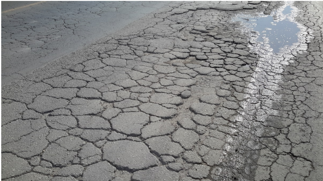
ภาพที่ 1.1 ลักษณะความเสียหายบนทางหลวงหมายเลข 331 บ.เนินผาสุข – มาบเียง ตอน 1 [1]
