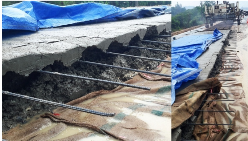
ภาพที่ 34 การพังทลายเสียหายเนื่องจากน้ำกัดเซาะทรายรองถนนคอนกรีต
