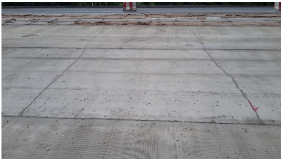
ภาพที่ 29.2 ลักษณะรอยแตกของถนน CRCP ในระหว่างการก่อสร้างทางหลวงหมายเลข 331 โดยถ่ายภาพภายหลังจากฝนตกเพื่อให้เห็นรอยแตกได้ชัดเจน
