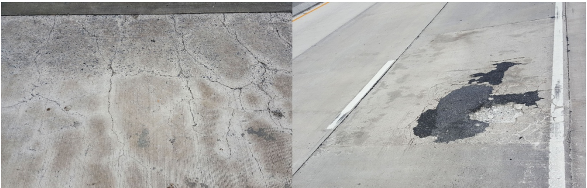
ภาพที่ 37.1 การแตกของถนน CRCP เนื่องจากใช้คอนกรีตที่พ้นช่วงเวลาการเวลาก่อตัวของคอนกรีต
