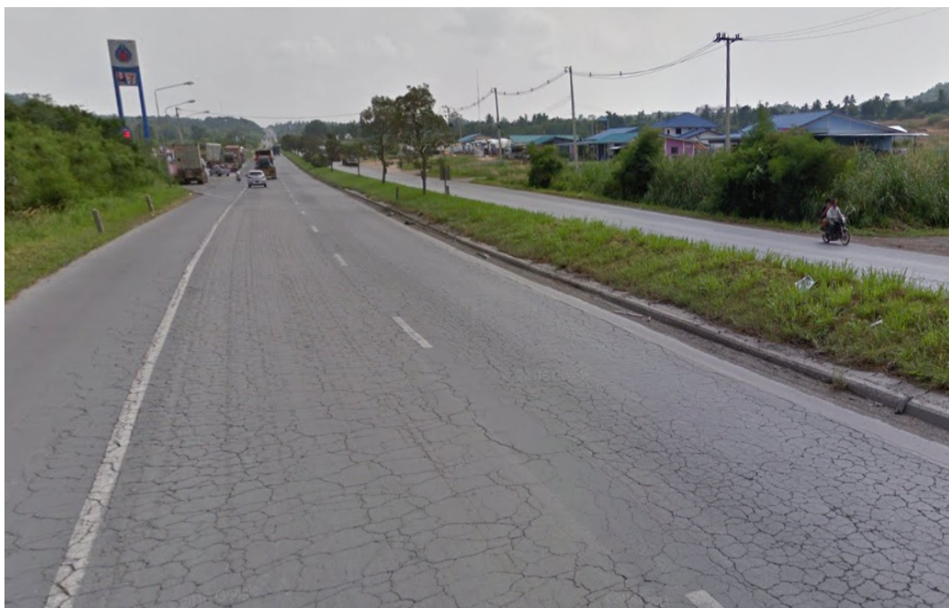
ภาพที่ 1.2 ลักษณะความเสียหายบนทางหลวงหมายเลข 331 บ.เนินผาสุข – มาบเียง ตอน 1
